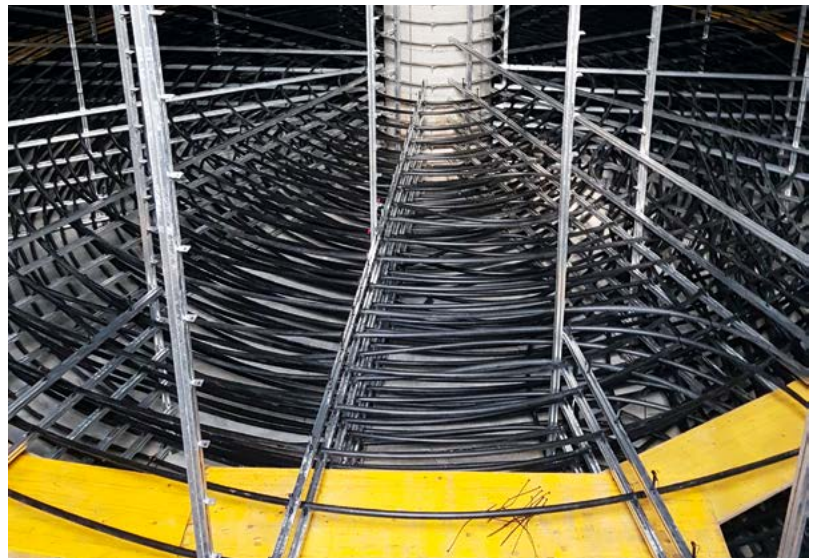
2019 entschied man sich bei Ikea Österreich bei der Errichtung eines Logistikzentrums für einen Eisspeicher als energieeffiziente Wärmequelle
